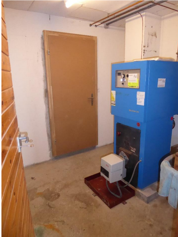
Chaudière à mazout
