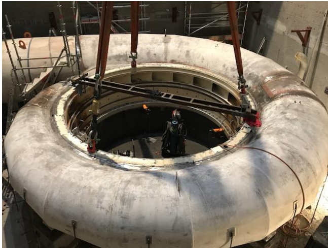
Une des bâches spirales qui ont dû être refaites à neuf car les pièces d'origine étaient défectueuses
