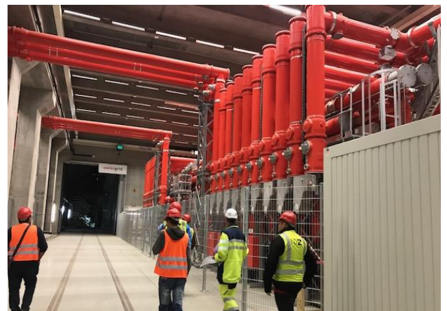
Dans le poste de couplage 400kV souterrain
