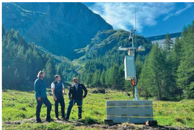
Système de radar provisoire
